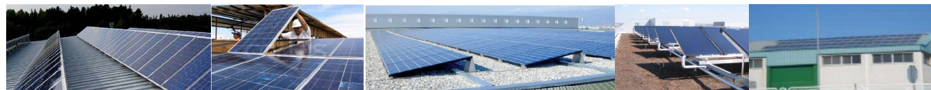
Instalaciones de energías renovables: Fotovoltaicas, Térmicas, Biomasa y Geotermia.
